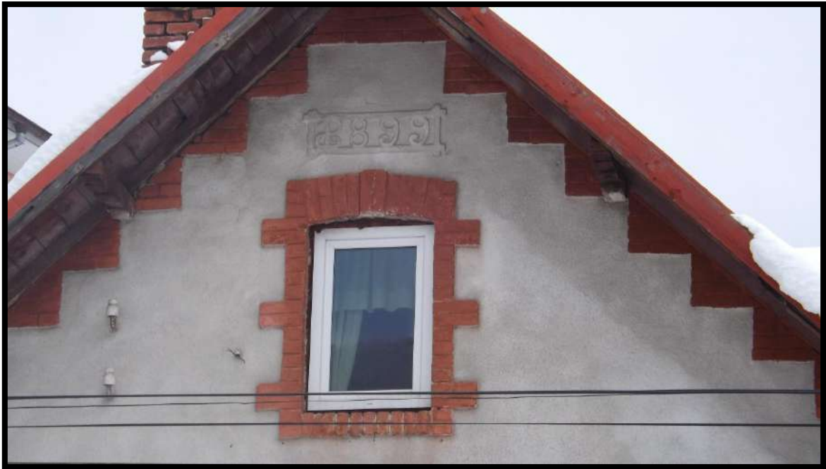
Str. Victoriei nr.48 în martie 2022, vestigiu în centrul localității al arhitecturii cu influențe ale stilului urban-industrial
